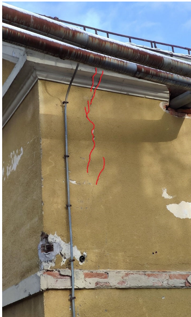
8 – oštećenja na vanjskom uzdužnom nosivom zidu
