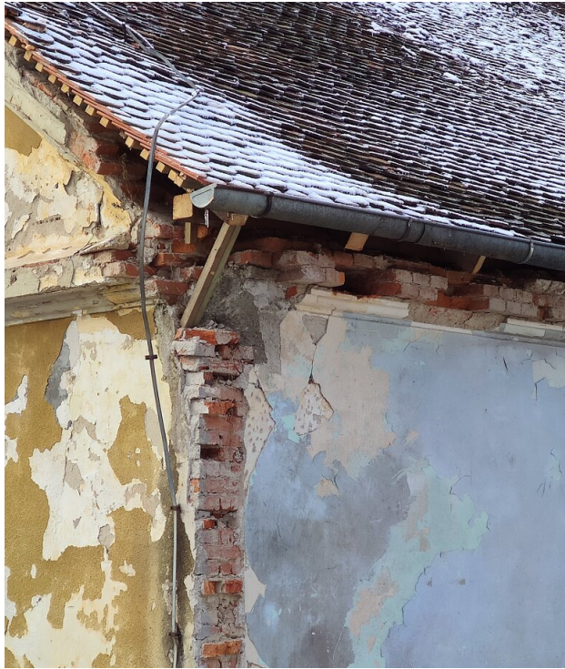
4 – oštećenja vrha nosivog zida
