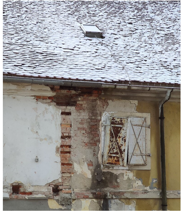
5 – oštećenja vrha nosivog zida
