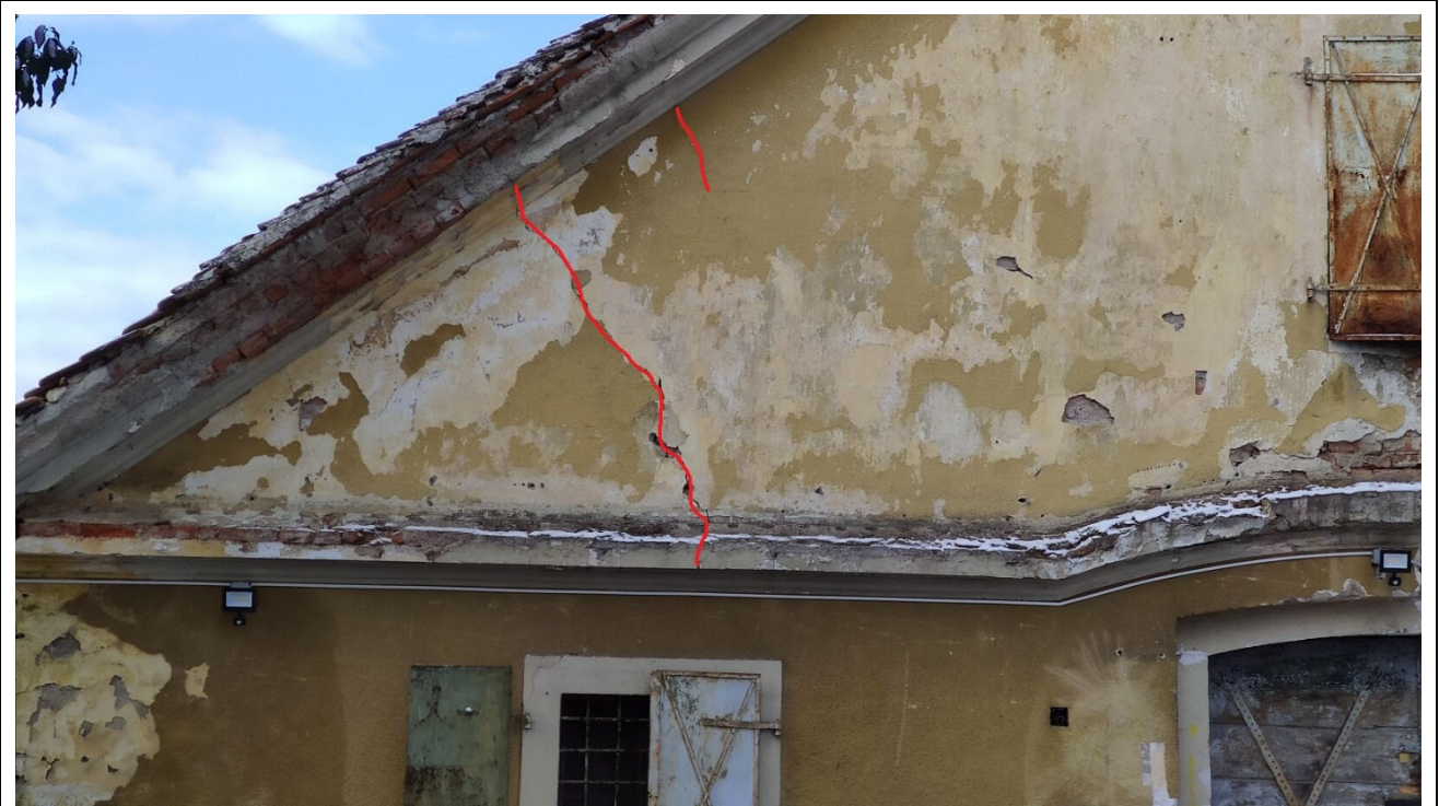
2 – oštećenja na zabatnom zidu
