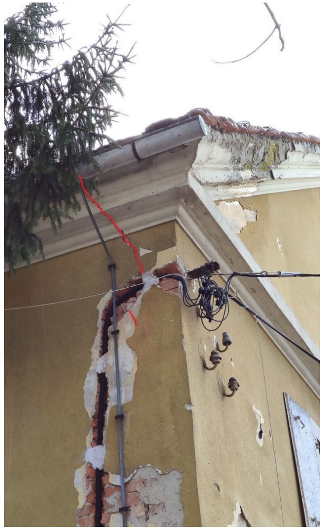
9 – oštećenja na vanjskom uzdužnom nosivom zidu
