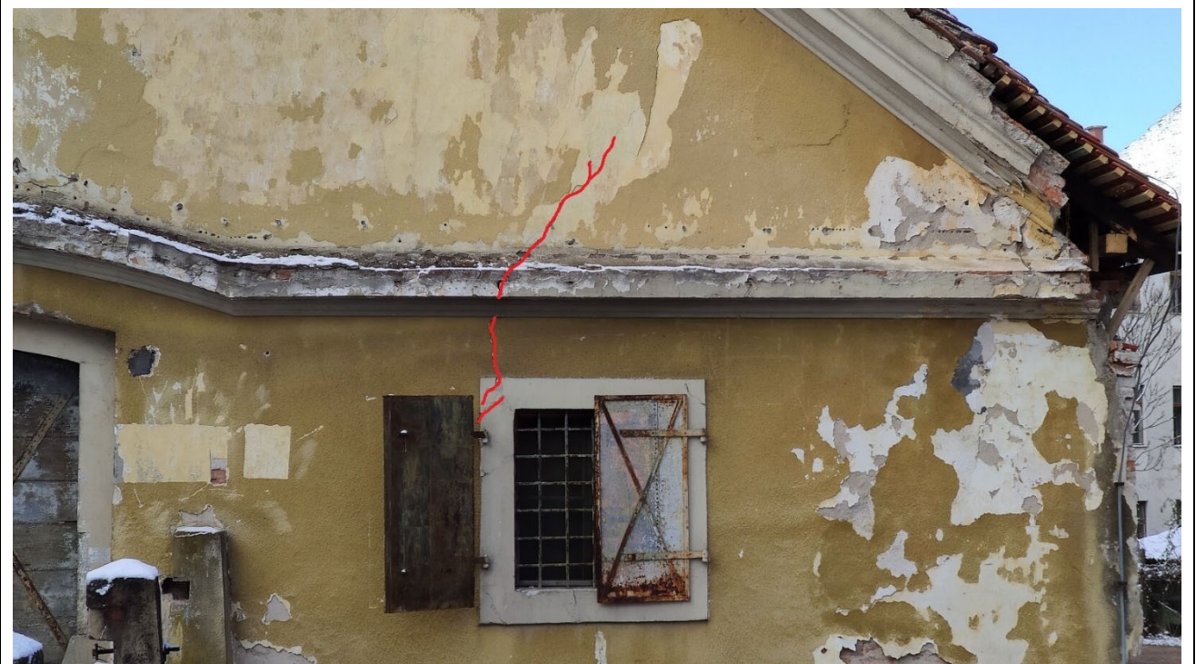
3 – oštećenja na zabatnom zidu
