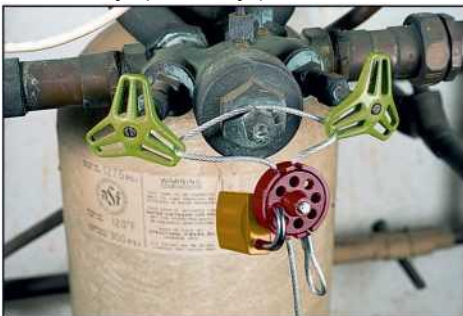
Savrtljivo čelično uže na ventilu
